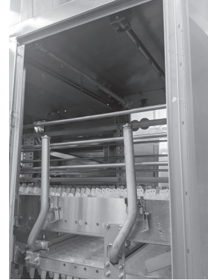
Rinçage chimique à basse température
