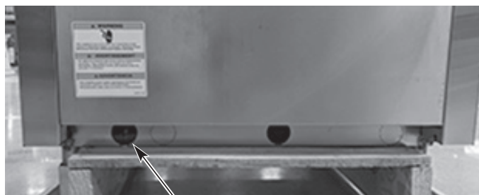
ELECTRIC CONDUIT HOLE
