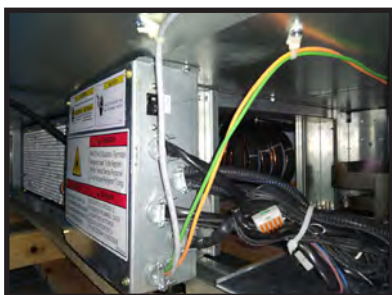
Caja de conexiones eléctricas del controlador
