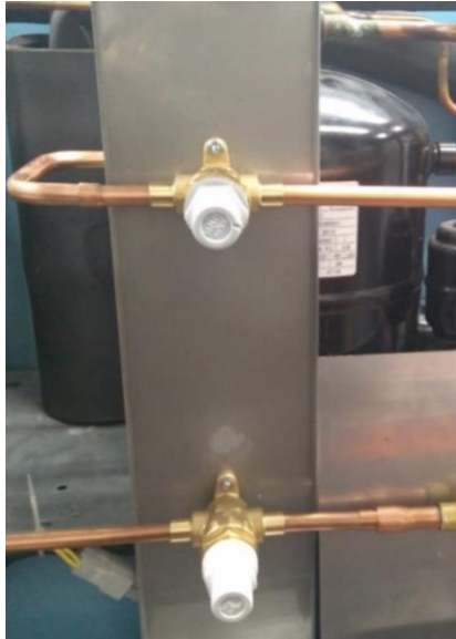
Image 6 : Vannes d'arrêt à l'intérieur de la machine à glace
