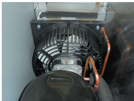
ENTRETIEN DU VENTILATEUR DU CONDENSEUR
